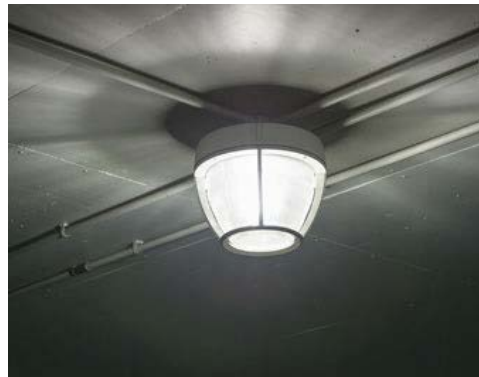
Metal Halide Lamp (before)
